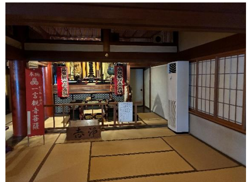
床置き型エアコン(計8台設置)
